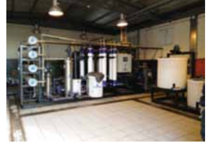
- Tratamiento final de líquidos por ultra y nano filtración.
