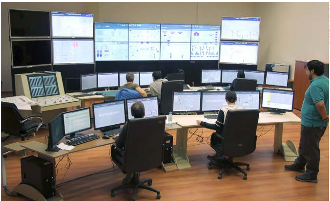
-CONTROL. El edificio de control de todo lo que ocurra con el CAREM y su operación, estará a pocos metros de la central y ya se ha montado con el software y el hardware que se utilizará para monitorear la central, y donde ya se capacitan los encargados de la tarea.
