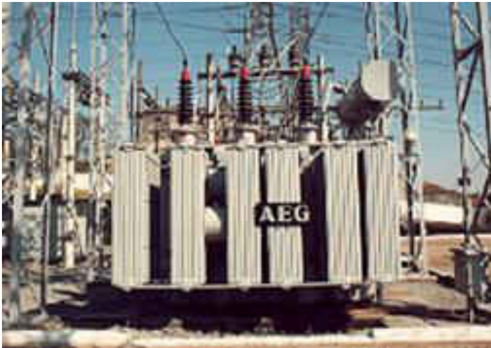
TRANSFORMADORES DE POTENCIA
