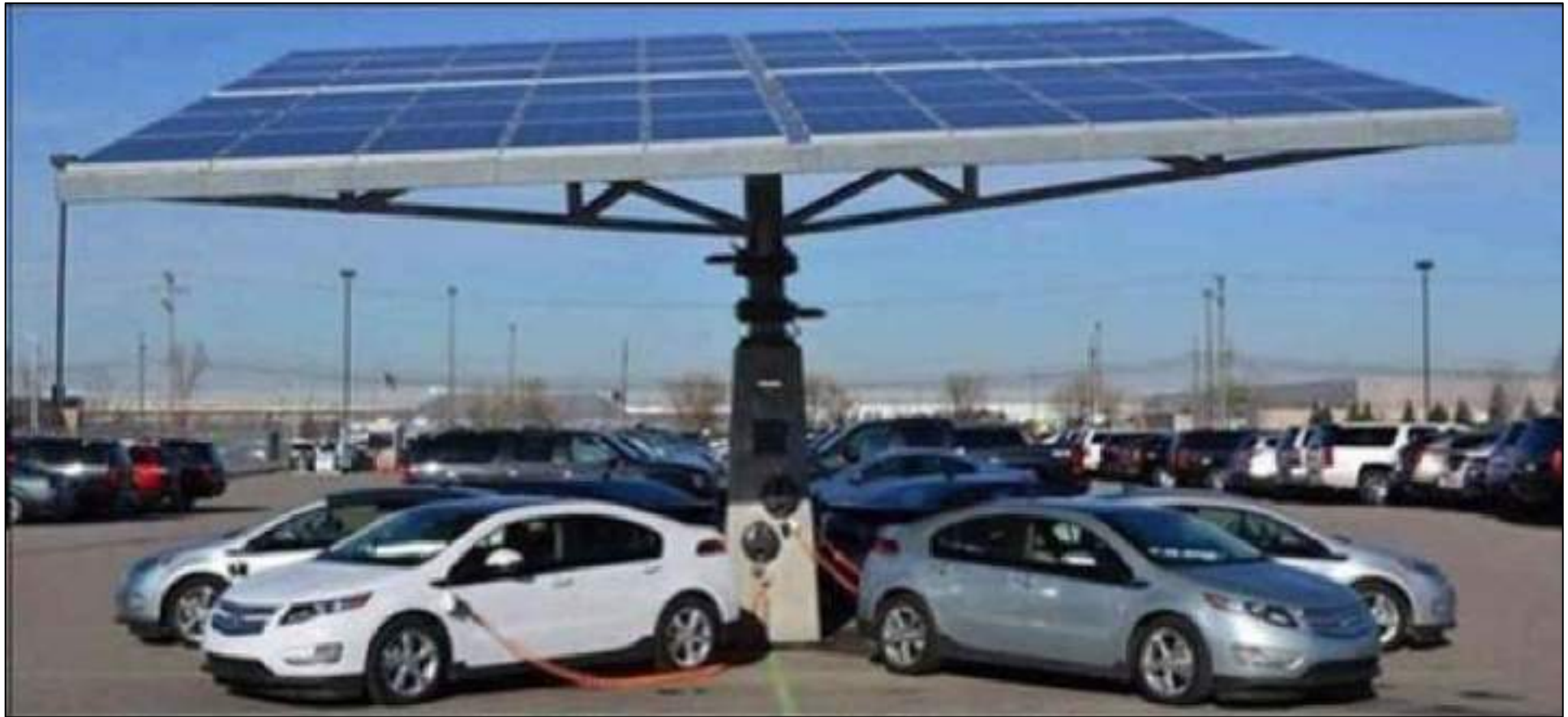
PANELES SOLARES FOTOVOLTAICOS INSTALADOS EN UNA SOMBRILLADE UNA PLAYA DE ESTACIONAMIENTO DE AUTOMÓVILES EN HOLANDA
