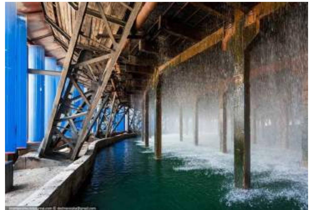
PILETA DE AGUA ENFRIADA
