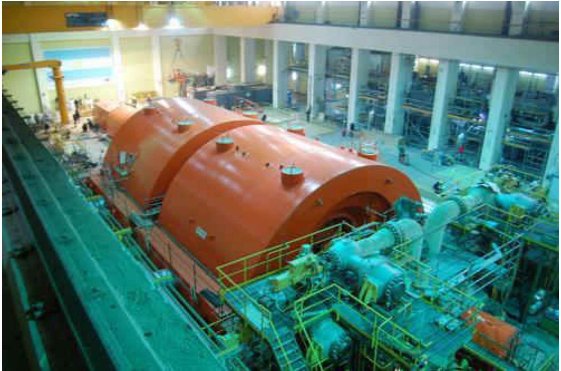
CENTRAL TÉRMICA DE COMBUSTIBLE NUCLEAR ATUCHA 2 TURBINA Y ALTERNADOR BUENOS AIRES, ARGENTINA
