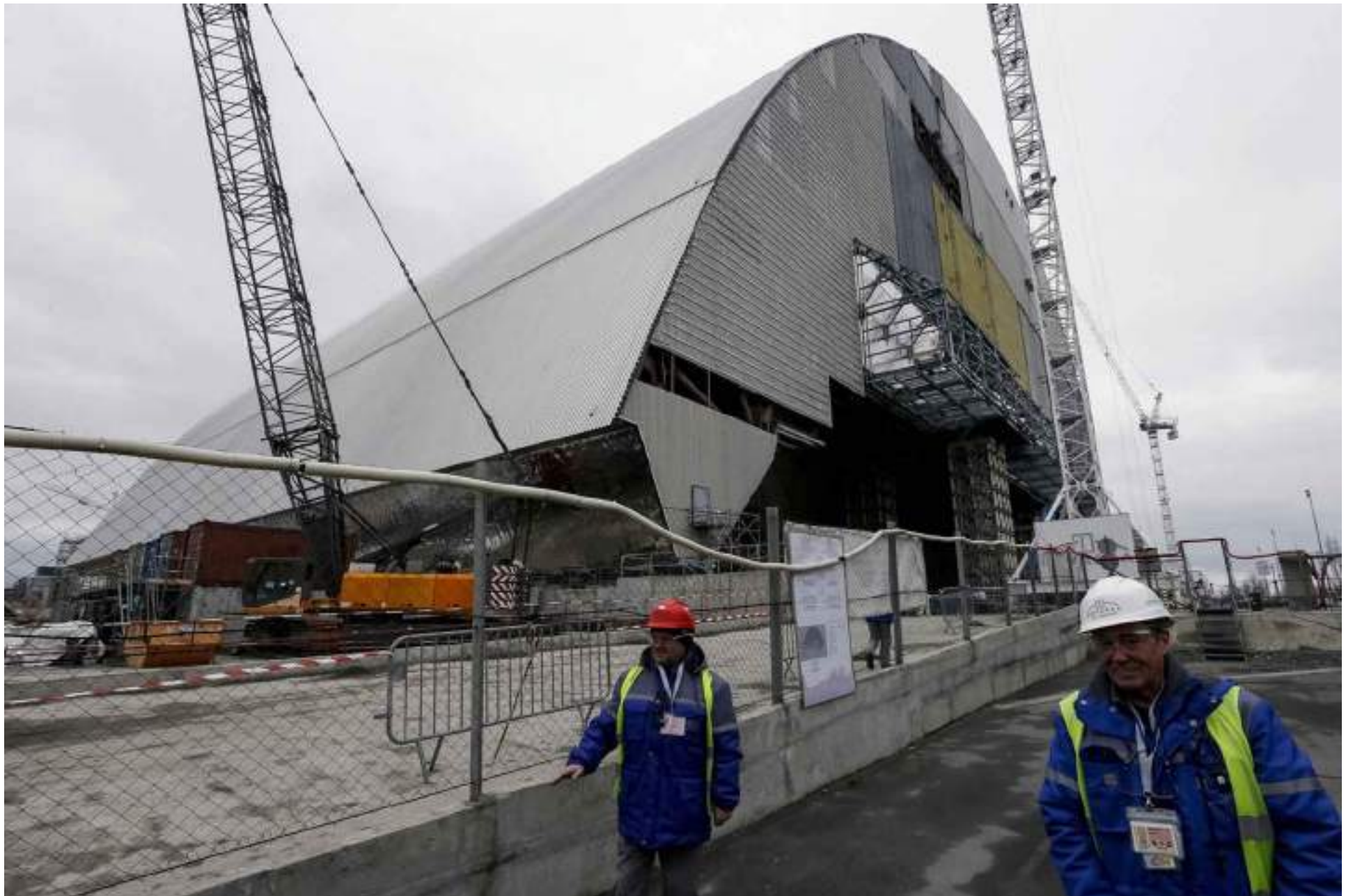
PROTECCIÓN CONTRA POSIBLES FUGAS DE RADIACIÓN
