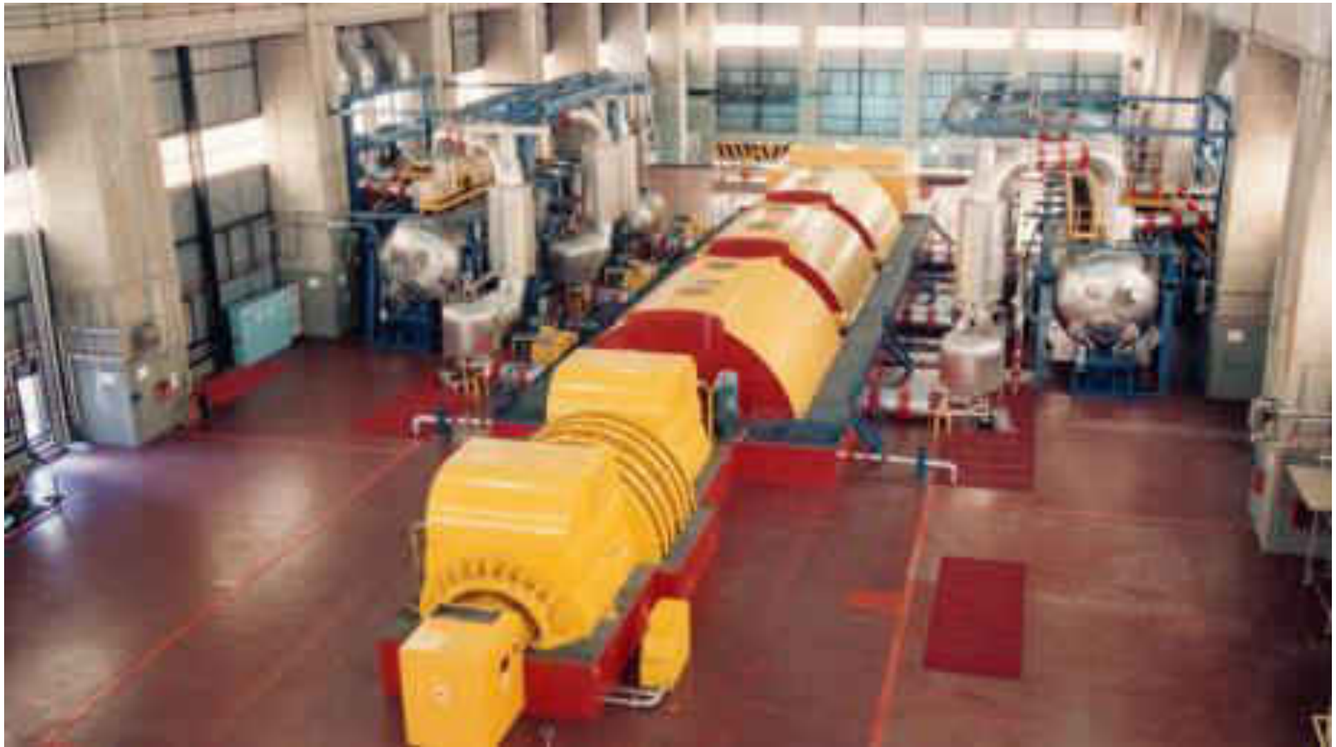
CENTRAL TÉRMICA DE COMBUSTIBLE NUCLEAR EN EL EMBALSE DEL RÍO III TURBINA Y ALTERNADOR CÓRDOBA, ARGENTINA
