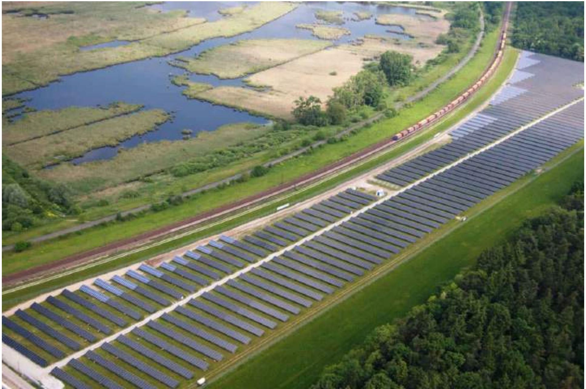
PARQUE SOLAR FOTOVOLTAICO EN BRUHRain Alemania
