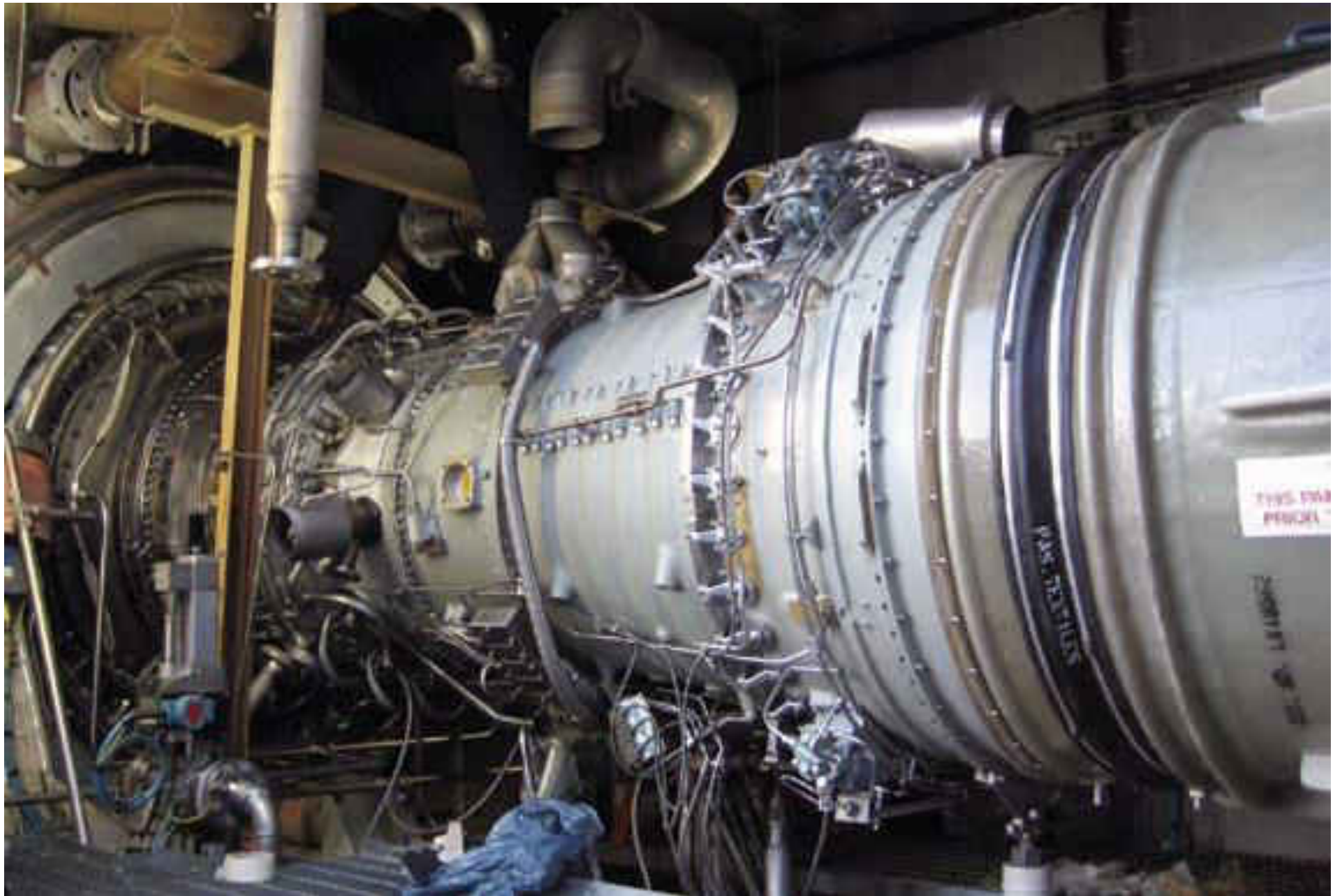
TURBINA ROLLS ROYCE Central en Ushuaia, Tierra del Fuego
